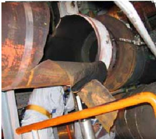
図1 美浜3号機配管破断部(右側が上流, 左側が下流)
